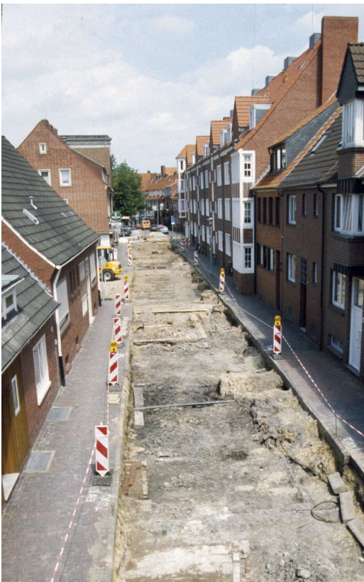
Abb. 1: Emden. Blick von der Pelzerstraße in die Emsstraße vor der Verlegung der Rohre. (Foto: B. Rasink)
